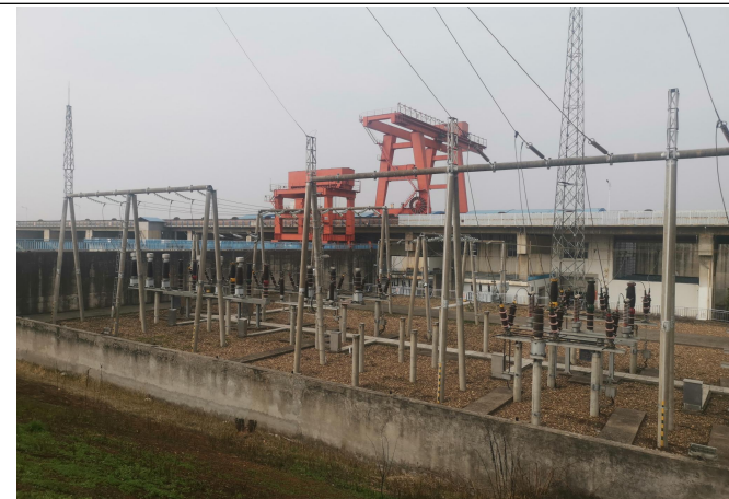
升压站现有的室外 GIS
