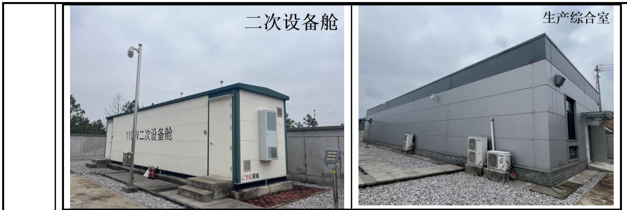
图 2-1 新田武当 110kV 变电站站内环境现状
